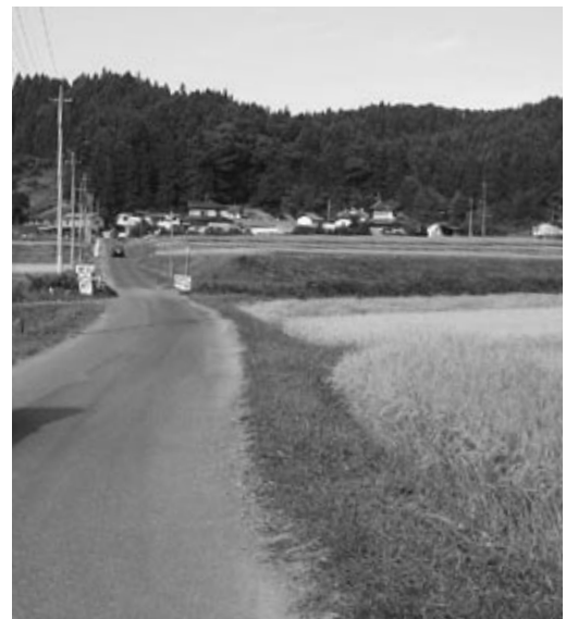
消石灰を施工した軟弱路盤は、舗装され堅固であるが凹凸が認められる。
