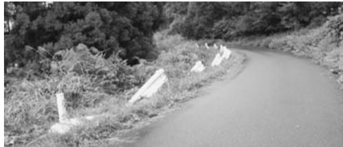
雪荷重により羽根及び支柱が倒壊している状況
