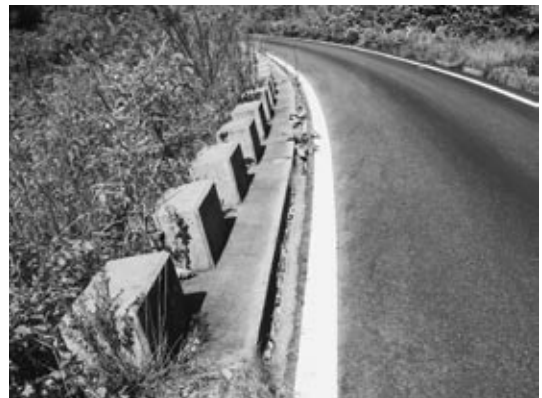
盛土箇所に施工した駒止工が傾斜し機能していない
