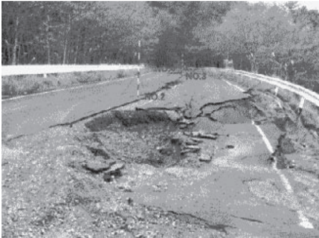
被災状況（舗装路面の亀裂、崩壊）
