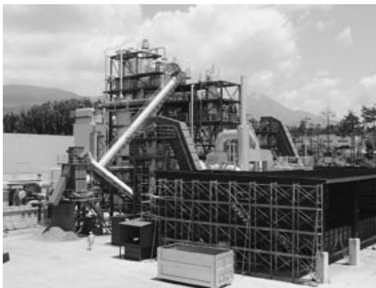
木質バイオマス利用施設
