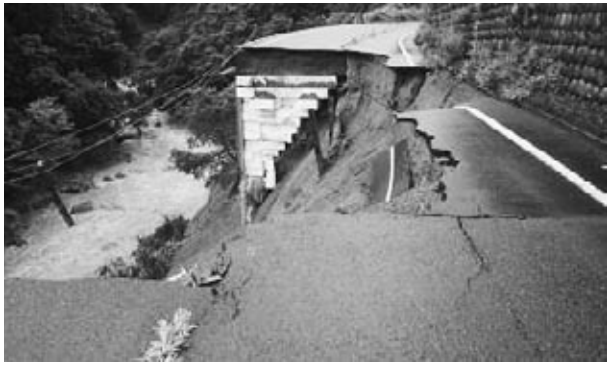
川入線（路体崩落の状況）
