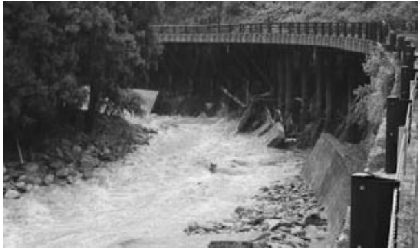
一の木線（護岸ブロックが被災した状況）
