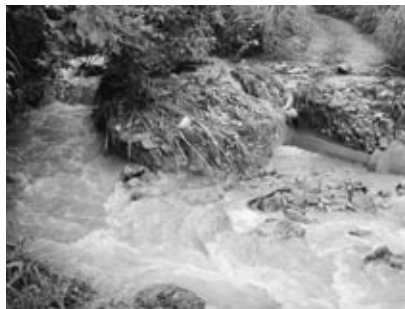
暗渠脇が洗掘された状況
