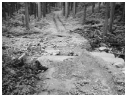
路面高まで土砂が積み上がった例
