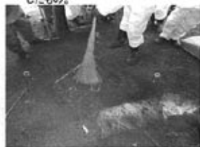
堆積有機物残さ除去後の土表面
