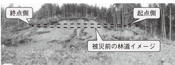
(写真5 林地崩壊に伴う路体の流失)
