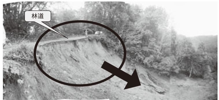
(写真1 路側の崩壊)
