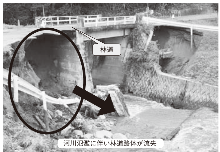
(写真3 路体の流失)
