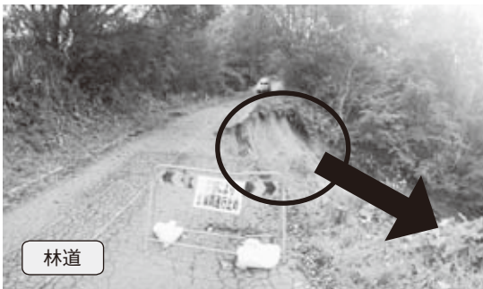
(写真2 路側の崩落)
