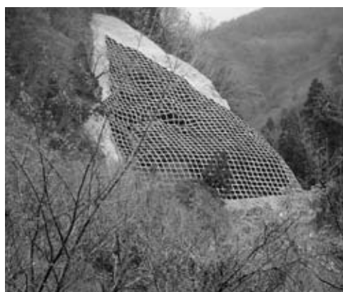
法面の崩落（竣工）
