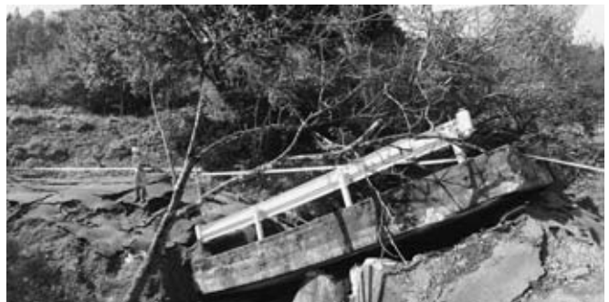
地すべりの押し出しにより被災した橋梁 (喜多方市板の沢沼ノ又線)
