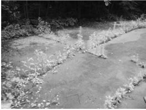
舗装面の亀裂から植生が繁茂した被災箇所 (平成30年大熊町)
