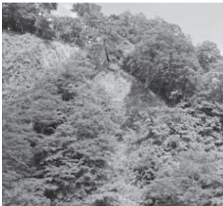
大戸地区崩壊斜面（施工前）
