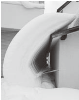
屋根の落雪（喜多方市）
